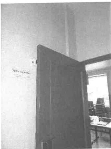
Escalier enclouonnés porte Desservant RDC au R+1
