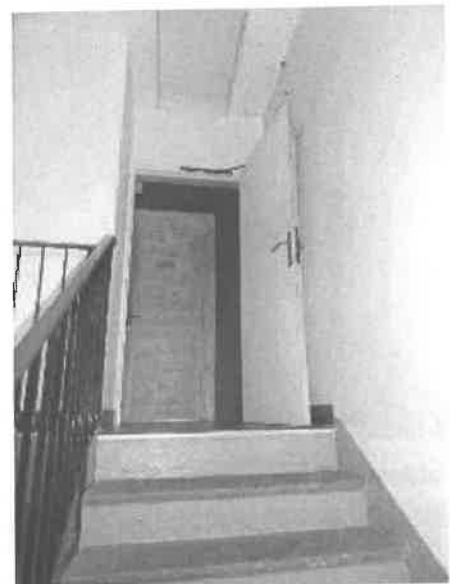
Porte coupe-feu avec Ferme- au R+1 dans l'escalier
